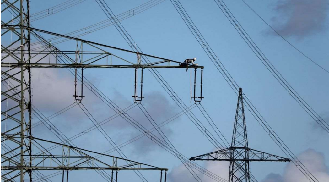
Linha de transmissão de energia
