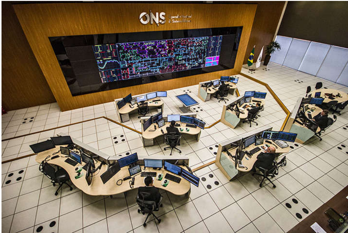
Sala de Operação do ONS, no Rio de Janeiro: cenário desafiador para operação com hidrologia ruim e grande volume de energia intermitente
